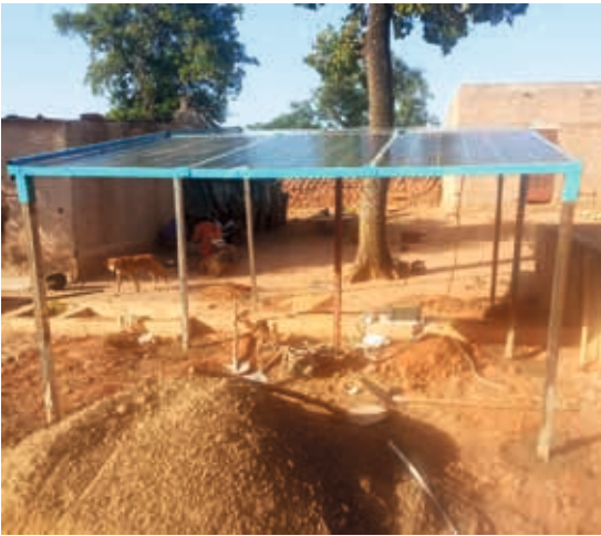
▲ Bronpomp op zonnepanelen.
